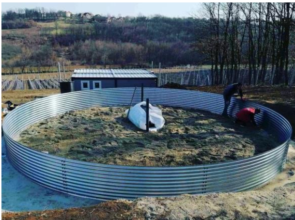
Слика 3. Приказ монтаже металног танка за акумулацију воде (Извор: Aqua.eco)
